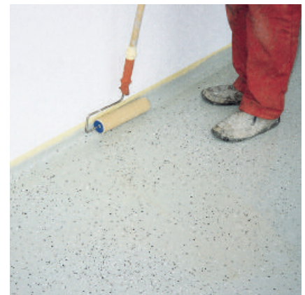
Der mit Farbchips abgestreute erste Auftrag von PCI Pursol 1K farblich muss mit PCI Pursol 1K transparent für einen dauerhaften Schutz nochmals überstrichen werden.
